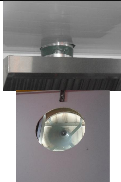
Huecos en la infraestructura
