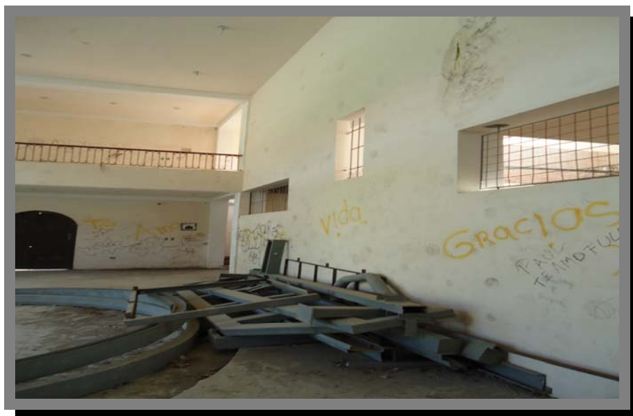
Figura 101. Infraestructura en mal estado del proyecto teleférico (María Reinoso 2010)
