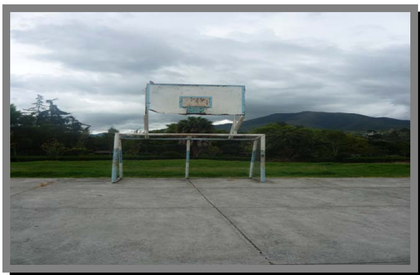
Figura 58. Estado de las canchas (María Reinoso 2010)
