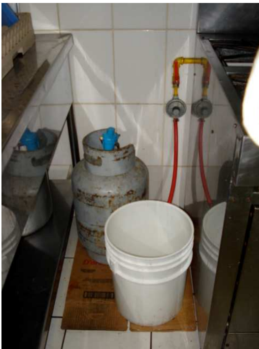
Figura #36 Fotografía -Tanque de gas dentro de la cocina
