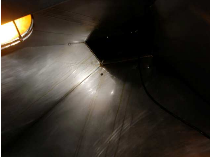
Figura #45 Fotografía- Interior de campana de extracción
